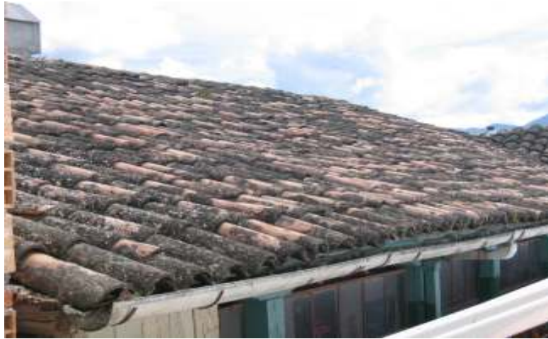
Das alte Dach des Schulhauses von „Nueva Cultura“
